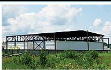
Холодильный склад для заморозки и хранения продукции птице-переработки, 33x21x4,5м.
