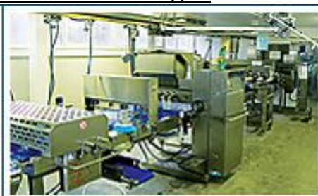
Оснащение производства зонами охлаждения, заморозки, хранения кондитерских изделий.
